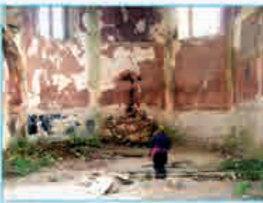
Басмала-мечеть в Донецькій області (Донецький район) після бомбардування 2011 р. (фото: Олександр Ситковський, архітект. ГО «Політична відповідальність»)
